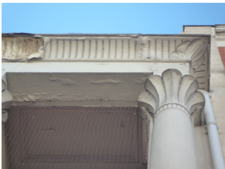
Las degradaciones justifican las obras
